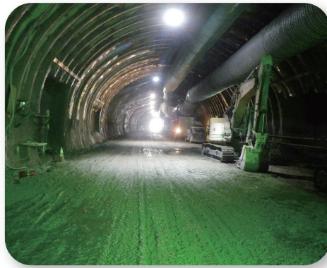
トンネル内照明
