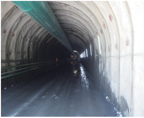
■ 工事現場・仮設照明として
